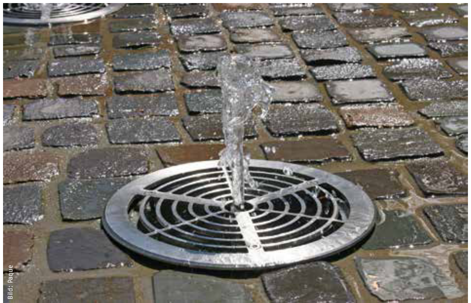
Wasserspiel: Trinkwassertrennstationen sind zwingend vorgeschrieben, wenn durch den Verwendungszweck eine Verkeimung des Trinkwassers über die Entnahmestelle befürchtet werden muss.
