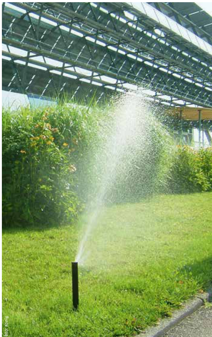
Unterflur-Beregnungsanlagen: Werden sie aus dem Trinkwassernetz gespeist, gehören sie nach den Regeln der Technik zur Kategorie 5 und benötigen eine Trinkwassertrennstation als Sicherheitseinrichtung.
